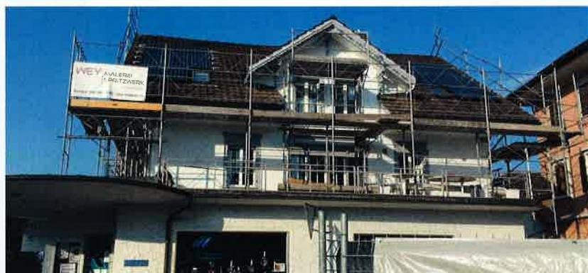
Viel Aufwand für kleine PV-Anlage: Montiert wurden 2 x 8 PV-Module mit sehr hohen spezifischen Kosten in Fr./kWp. (Referat Urs Muntwyler)
