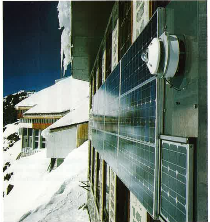
Bild 1 Blick auf die eine Hälfte des Solargenerators der Anlage Jungfrauoch (3454 m) mit beheiztem Pyranometer und Referenzzelle zur Strahlungsmessung. Im Hintergrund das Restaurant Jungfrauoch.
