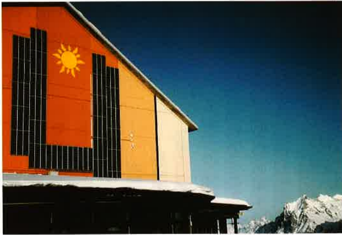
Bild 5 Solargenerator der Photovoltaikanlage Birg (4,134 kWp) auf 2670 m.
