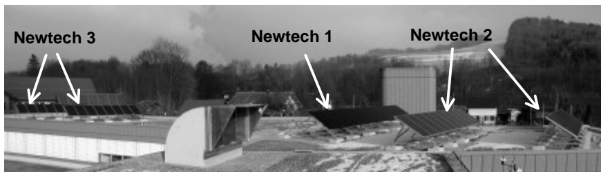
Bild 1: Ansicht des Solargenerators mit den 3 Teilanlagen Newtech 1 – 3
