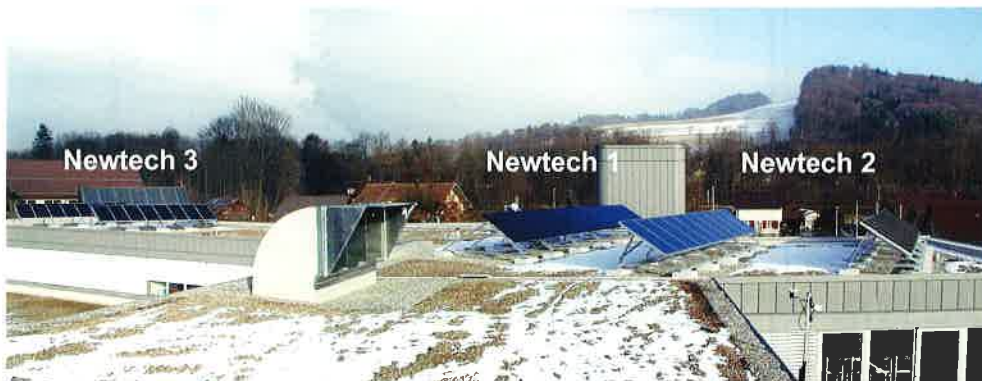
Bild 1 Ansicht des Solargenerators mit den drei Teilanlagen Newtech 1 – 3.
