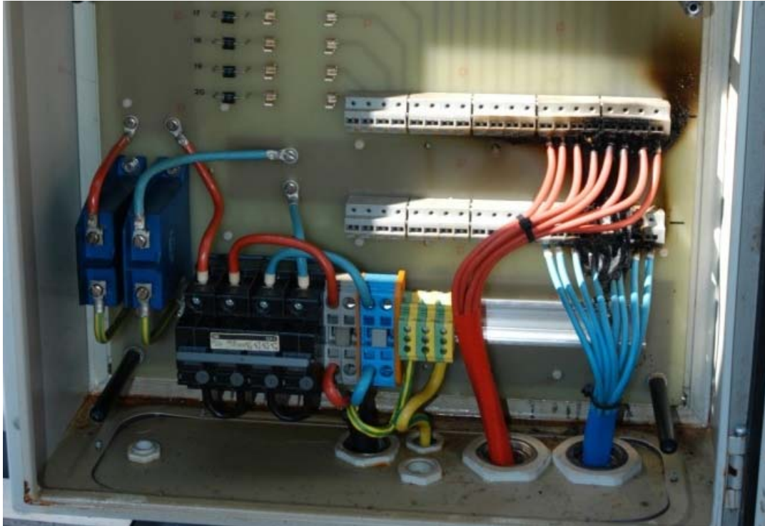
Bild 1: Schäden infolge eines durch einen Lichtbogen im Generator-Anschlusskasten ausgelösten Schwelbrandes.
